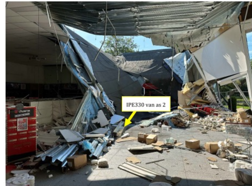
figuur 8 Schade gezien vanuit de binnenzijde van het bedrijfspand.
