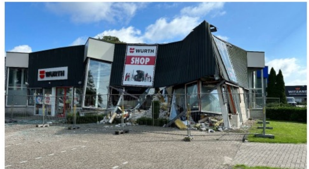
figuur 7 De geveldelen op de zuidwesthoek zijn naar binnen getrokken bij de gedeeltelijke dakinstorting.
