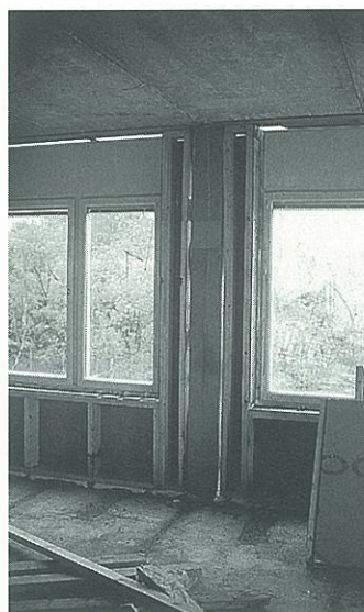
Stalen kolommen zijn, vanwege de relatief geringe afmetingen, eenvoudig te integreren in de gevel. De vlakke binnenwand die zo ontstaat, wordt in de vastgoedsector hoog gewaardeerd.
