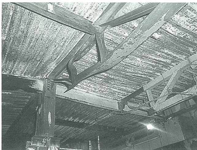
Afbeelding 4. Overzicht van de brandruimte met een vervormde kolom, walsliggers met lokaal bezwijken en een vakwerkligger met uitgeknikte rand- en wandstaaf
