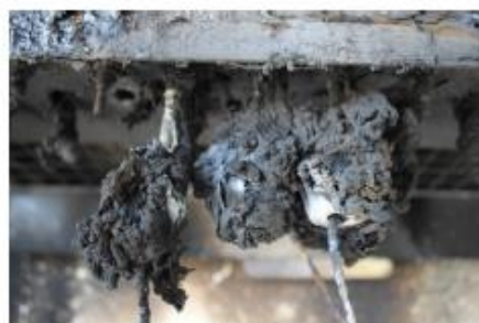
Connectoren onder aan de omvormer
